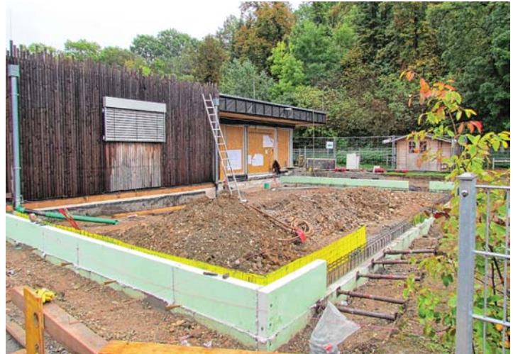
Die Rohbaumaßnahmen für den Anbau eines dritten Gruppenraumes an die Kinderkrippe »Im Baumgarten« wurden kürzlich begonnen. Aufgrund des gestiegenen Preisniveaus im Bausektor zeichnet sich schon jetzt eine Verteuerung der Maßnahme ab.
